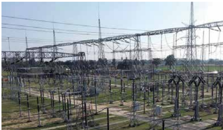
Rys. 2. Stacja rozdzielcza wysokich napięć 400/110 kV.
