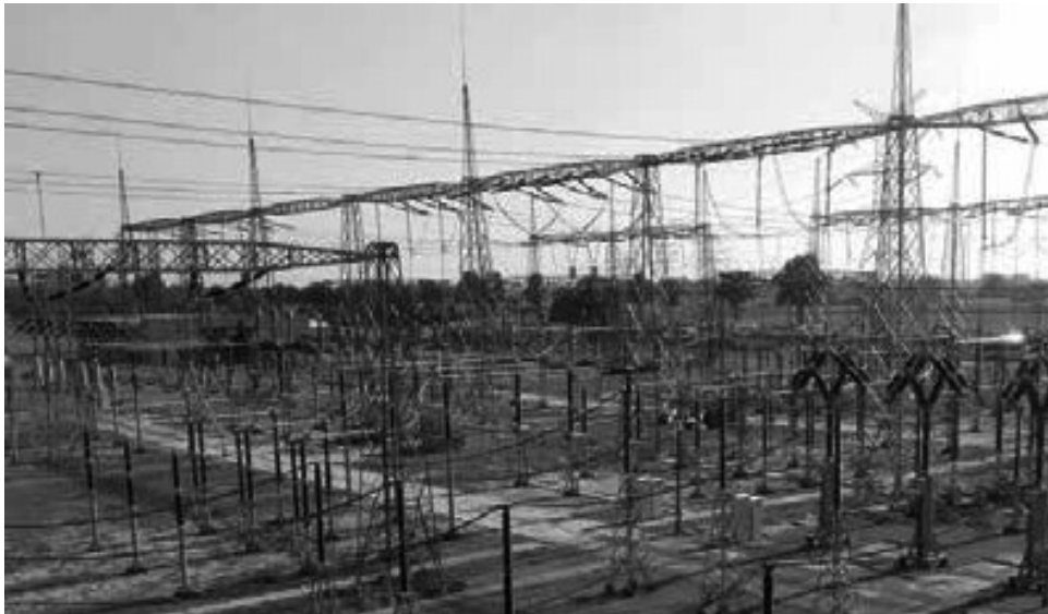
Rys. 2. Stacja rozdzielcza wysokich napięć 400/110 kV.
